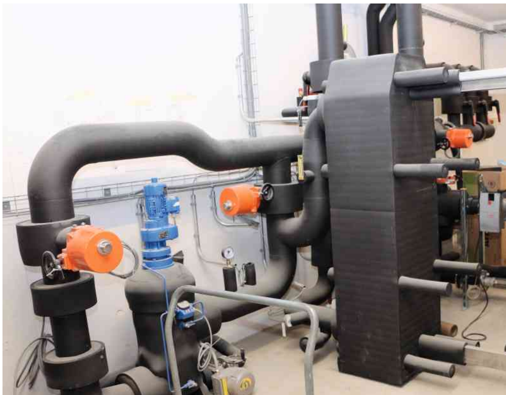
Auf dem Bild sieht man den bereits isolierten Plattentauscher (Systemtrennung Grundwasser-Wärmepumpe) und den Kerzenfilter.
