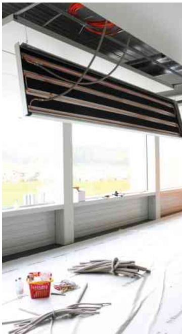
Dank dem Vierleitersystem der Deckensegel ist es möglich, in einem Raum zu kühlen, gleichzeitig in einem andern zu heizen.
